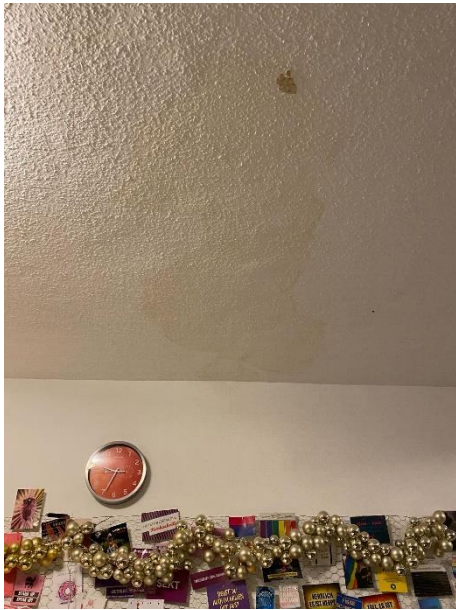
Foto Befall unterer Raum, 21.09.21
