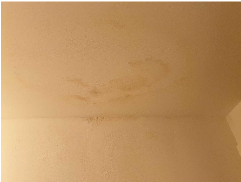
Foto Befall hinterer Toilettenraum, 17.10.21
