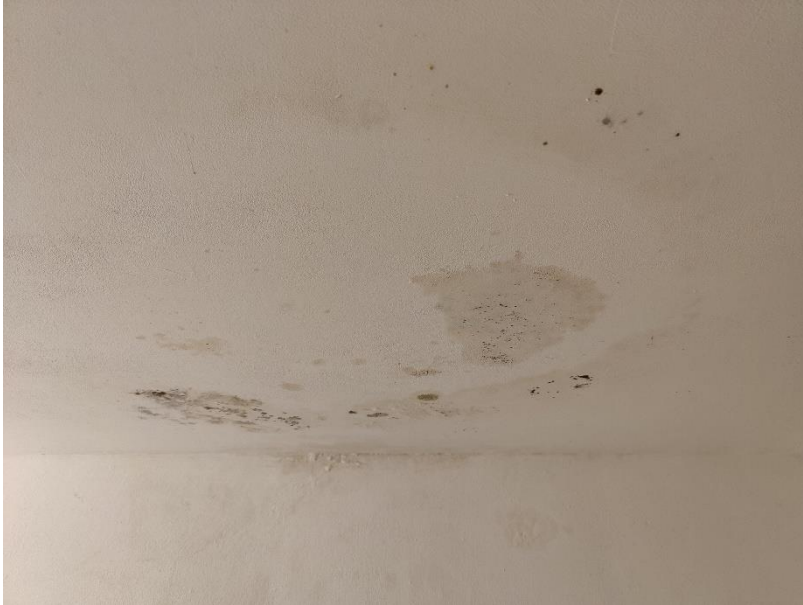
Foto Befall hinterer Toilettenraum, 03.10.21
